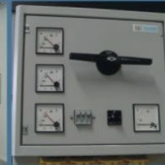
Medición y seccionamiento
