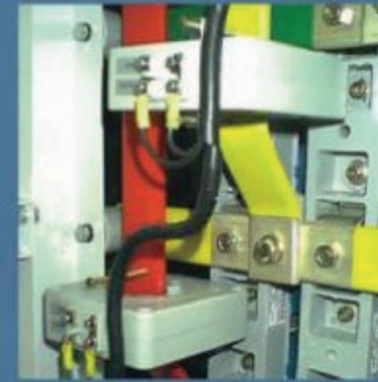
Transformador de medida.
